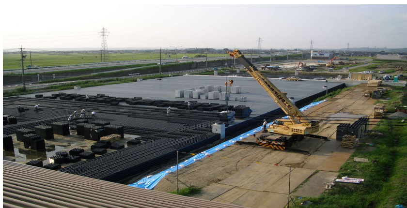
Công trình tại tỉnh Ishikawa, Nhật Bản Dung lượng: 9200m 3
