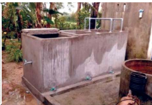
Tận dụng các bể/bồn/ hồ chứa có sẵn để chứa nước mưa
